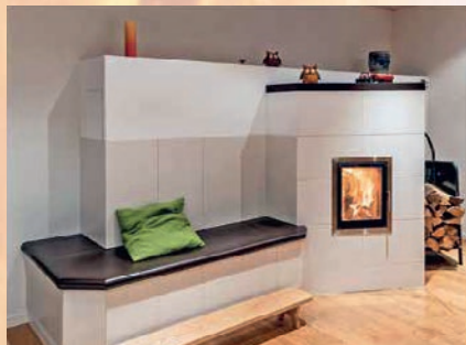
Der Speicherofen heizt das ganze Haus
